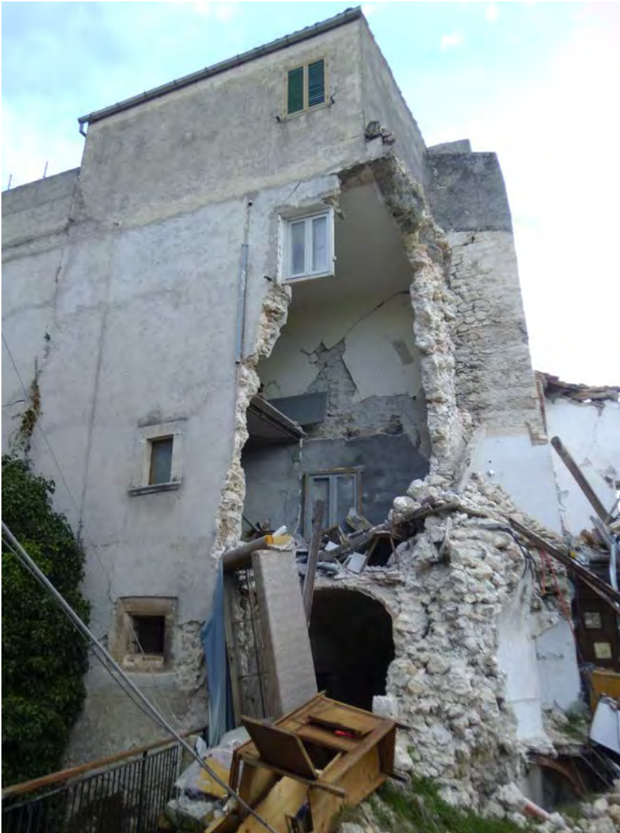
Figura 5. Il cordolo in c.a. inserito in murature di scarsa qualità risulta spesso eccessivamente rigido, con effetti devastanti sotto l'effetto del sisma (Civitavecchia, AQ).
