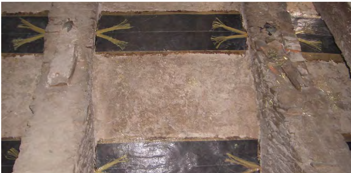
Figura 8. Minimo intervento di consolidamento con materiali compositi (fibre di carbonio e fibre di vetro in matrice resinosa) di una volta a padiglione nel Palazzo Comunale di Modena (progettisti proff. Angelo Di Tommaso e Carlo Blasi): l'intervento blocca il meccanismo di danno individuato senza ostacolare possibili adattamenti al mutare delle condizioni al contorno.
