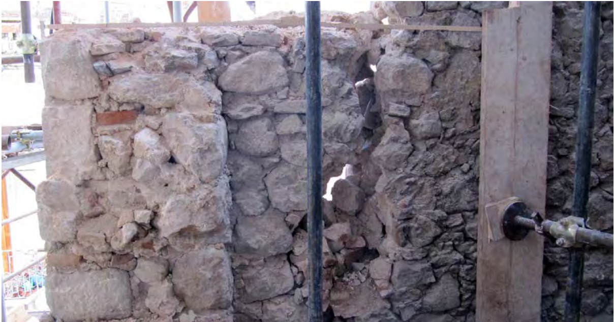
Figura 19. L'Aquila, oratorio di San Giuseppe dei Minimi, lesione in corrispondenza dell'aggancio tra il cantonale e la muratura perimetrale (foto di S. Cecamore).
