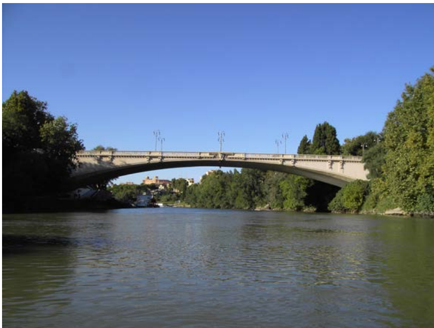
Figura 1. Roma, ponte Risorgimento, Giovanni Antonio Porcheddu con François Hennebique, 1909-1911, vista attuale ( https://it.wikipedia.org/wiki/Ponte_del_Risorgimento_(Roma)#/media/File:Tevere_-_PonteRisorgimento1.JPG , ultimo accesso 10 luglio 2023).
