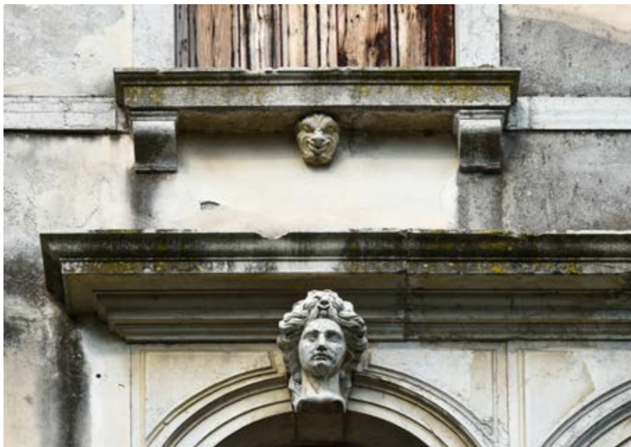
Figura 12. Canda (Rovigo). Villa Nani Mocenigo, prospetto orientale, particolare del mascherone in chiave dell'arco nella finestra laterale della trifora del primo piano e di quello utilizzato come gocciolatoio alla base dei bancali delle finestre del secondo (foto E. Montalti, 2019).
