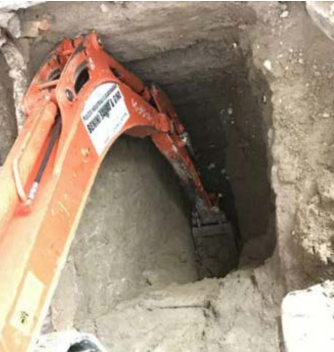
Figura 12. Indagini strutturali: in alto, la messa in luce di elementi verticali in c.a.; in basso, indagini sulle fondazioni all'angolo nord-est (da Linee Guida per lo sviluppo della Progettazione , 31.07.2020).
