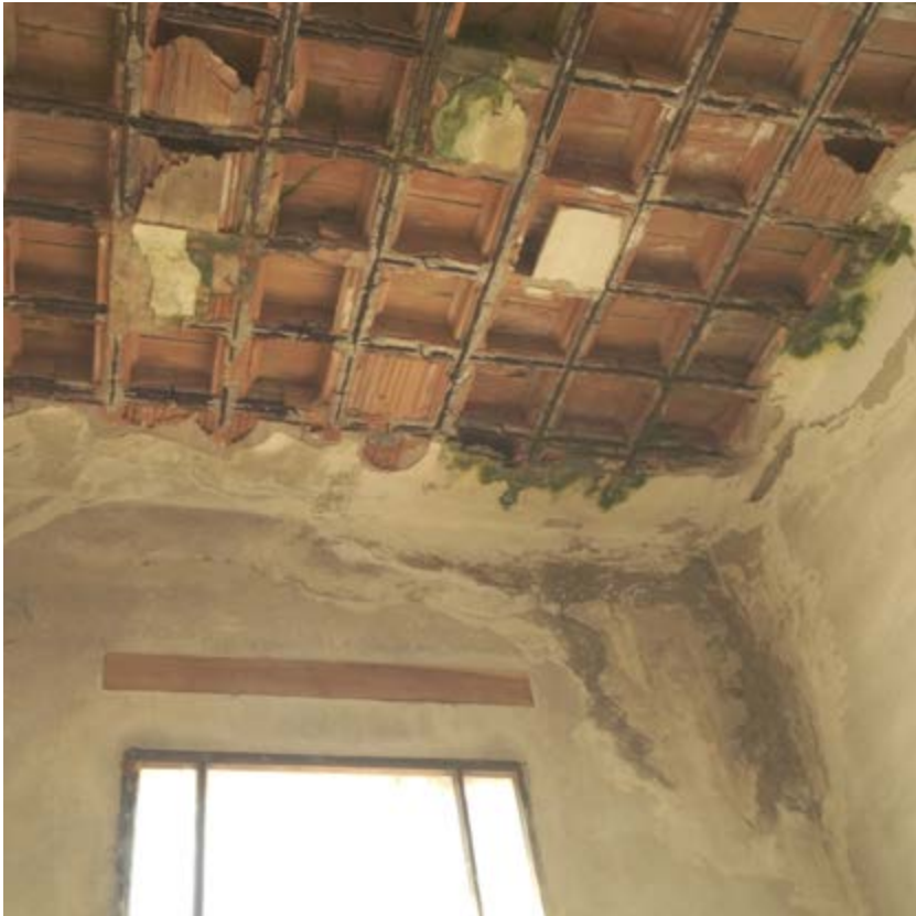
Figura 6. Predappio (Forlì-Cesena). Casa del Fascio. Dettaglio dello stato di conservazione del solaio di uno degli ambienti del primo piano (foto B. Verasani, V. Manzini, 2020).
