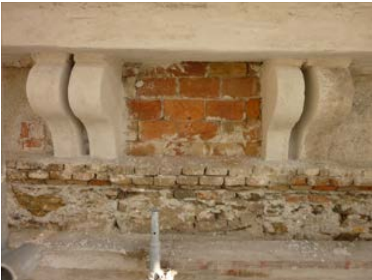
Figura 14. Savona, santuario di Nostra Signora della Misericordia, fronte principale dell’Ospizio dei poveri. Particolare della cornice in mattoni pieni che taglia un’apertura successivamente tamponata (foto S.F. Musso, 2012).
