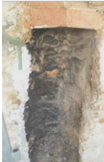
Figura 41. Savona, santuario di Nostra Signora della Misericordia. Dettagli della canna fumaria "in spessore di muratura" scoperta in fase di cantiere (foto S.F. Musso, 2013).
