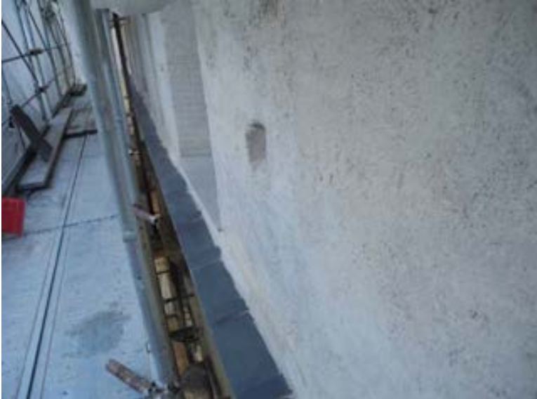
Figura 27. Savona, santuario di Nostra Signora della Misericordia, fronte principale dell'Ospizio dei poveri. Particolare della nuova copertina in ardesia a protezione delle cornici marcapiano (foto S.F. Musso, 2012).
