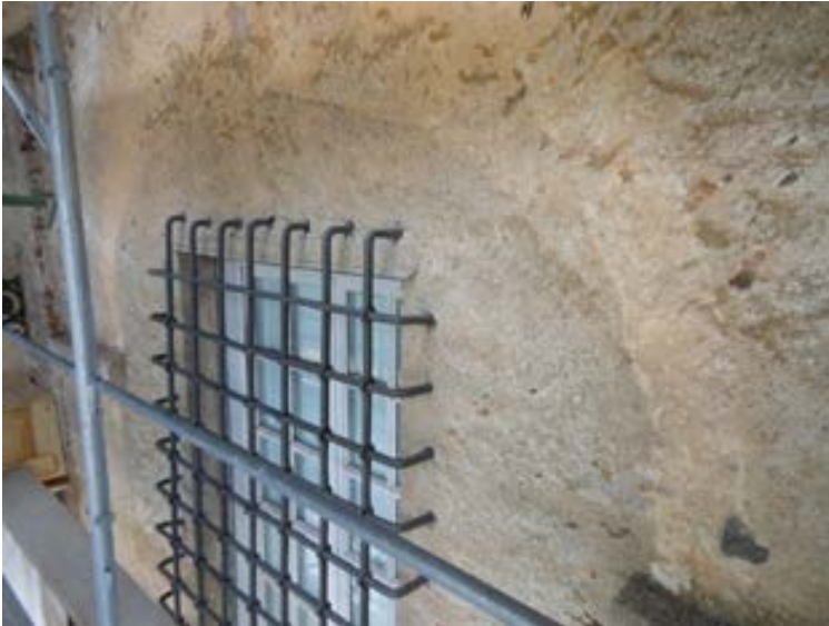
Figura 11. Savona, santuario di Nostra Signora della Misericordia, fronte principale dell'Ospizio dei poveri. Particolare della ghiera di un arco in mattoni, probabile traccia di un portico tamponato in fase successiva (foto S.F. Musso, 2012).
