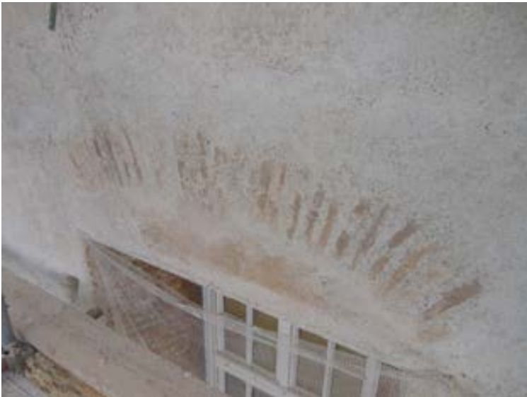
Figura 12. Savona, santuario di Nostra Signora della Misericordia, fronte principale dell'Ospizio dei poveri. Arco di scarico inglobato nella muratura del secondo piano (foto S.F. Musso, 2012).
