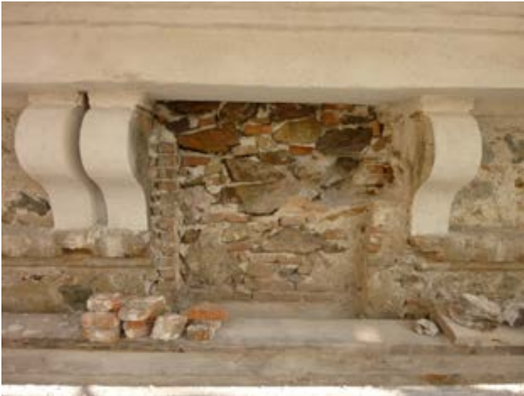
Figura 13. Savona, santuario di Nostra Signora della Misericordia, fronte principale dell’Ospizio dei poveri. Particolare del cornicione; sono evidenti le tracce di alcune aperture ricavate in rottura nella muratura preesistente e successivamente tamponate (foto S.F. Musso, 2012).
