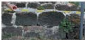
08 | Castello di Pontes, Coghini Muro | BASALTO
