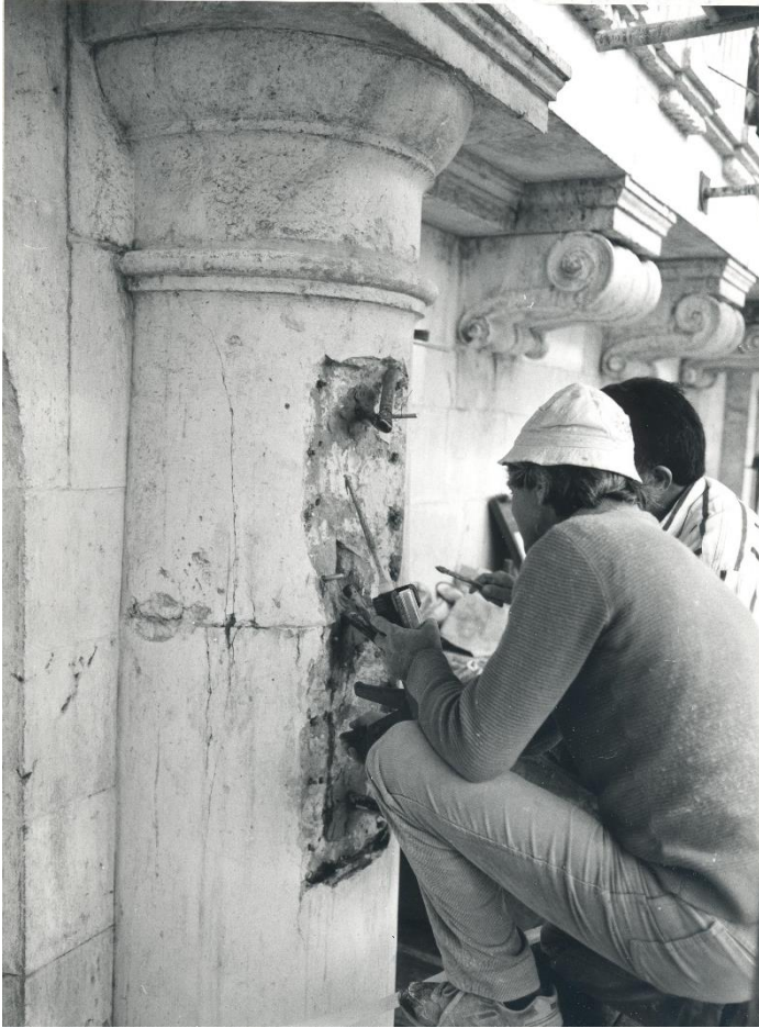
15. Una delle immagini del restauro nel 1992; gli elementi lapidei mostrano fessurazioni e mancanze (SABAP-Aq 1992).
