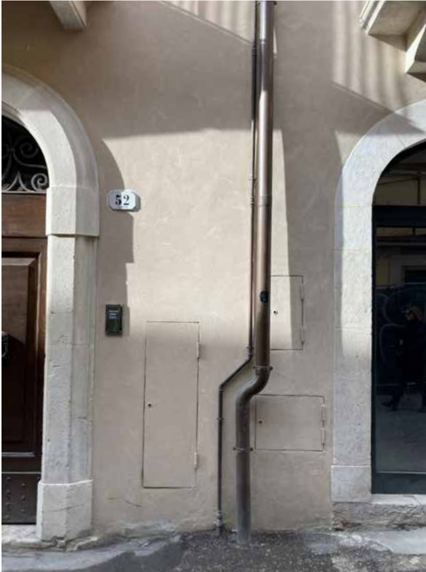
Figura 5. L'Aquila. La consuetudine di collocare su strada i contatori delle utenze (comunemente imposta dai gestori delle forniture) provoca diffusi scassi nelle murature, eseguiti sulle porzioni resistenti senza alcuna cognizione delle criticità strutturali. Il problema è particolarmente evidente nei centri storici, in corrispondenza delle unità abitative appena ristrutturate (foto C. Bartolomucci, 2023).
