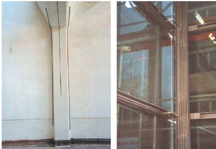
Figure 3a-b. Alf Lechner Museum, Ingolstadt, Sistema di temperierung installato a pavimento e su serramento esterno.
