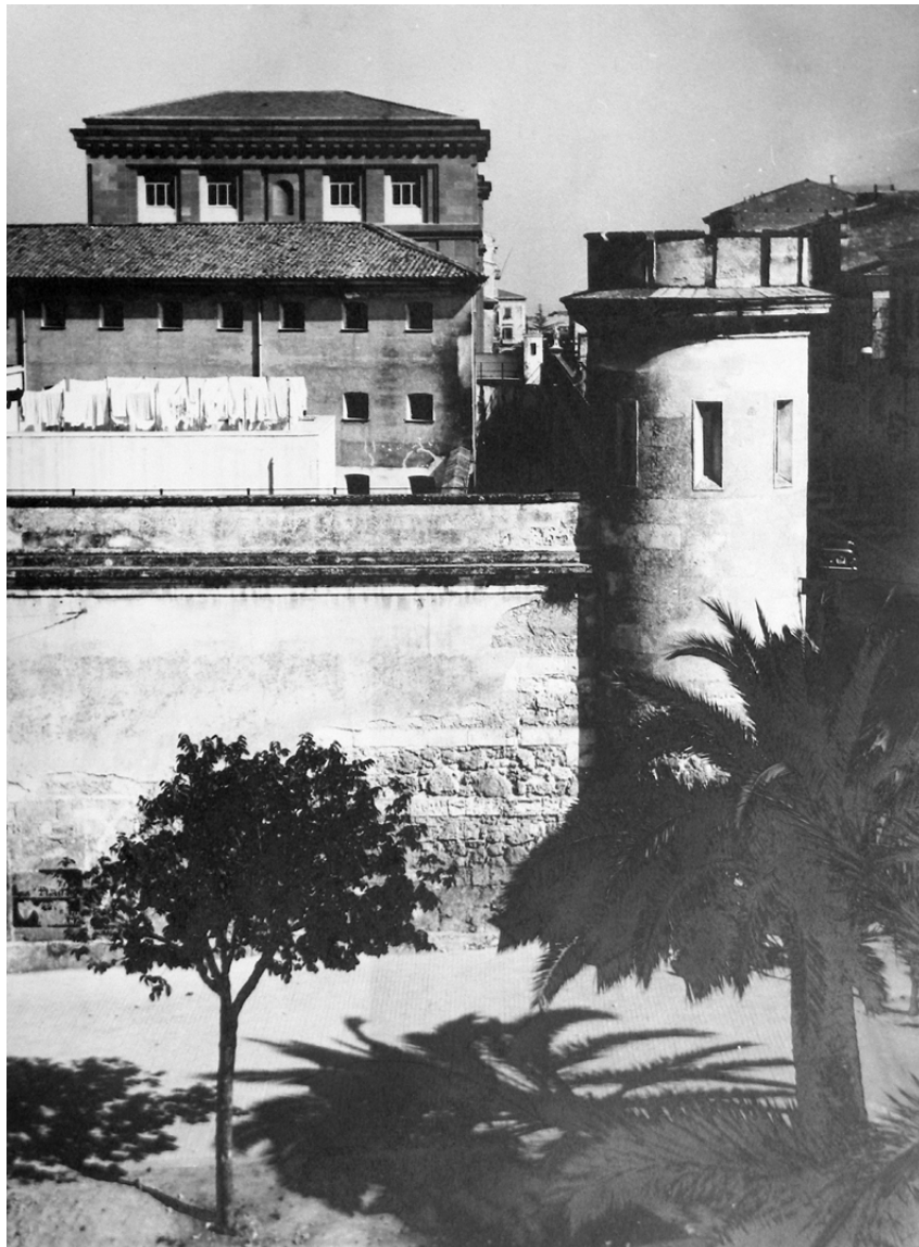
Figura 5. Sassari, Carcere di San Sebastiano. Stato di fatto del muro di cinta lungo la via Giorgio Asproni alla fine degli anni Cinquanta del Novecento. Si noti l'estesa lacuna di intonaco sul muro di cinta che rivela la tecnica muraria e i materiali impiegati nella sua costruzione. ASGC, Sassari, Carcere di San Sebastiano, Progetto di Sistemazione e Ampliamento (1957-1961).
