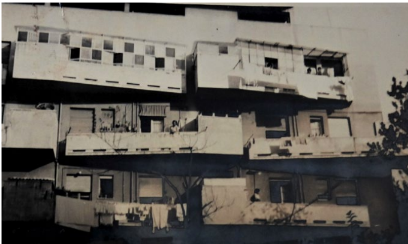
Figura 18. Stefania Filo Speziale, rione a Capodichino, edificio a cinque piani, prospetto interno con il particolare dei lavatoi sui balconi trasformati in verande, foto dell'epoca. ACER, Archivio Storico IACP, Faldoni, Napoli Generali, Licenze Edilizie .
