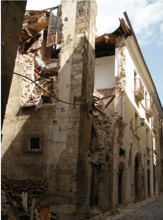
Figura 2. L'Aquila, edificio in via Paganica, angolo via San Benedetto in Perillis, agosto 2009. La compattezza del cantonale rimasto in piedi (oggi demolito) e l'interruzione dei tiranti, i cui capichiave sono ancora visibili, fa supporre che il crollo sia dovuto a cedimenti localizzati (foto C. Bartolomucci, 2009).
