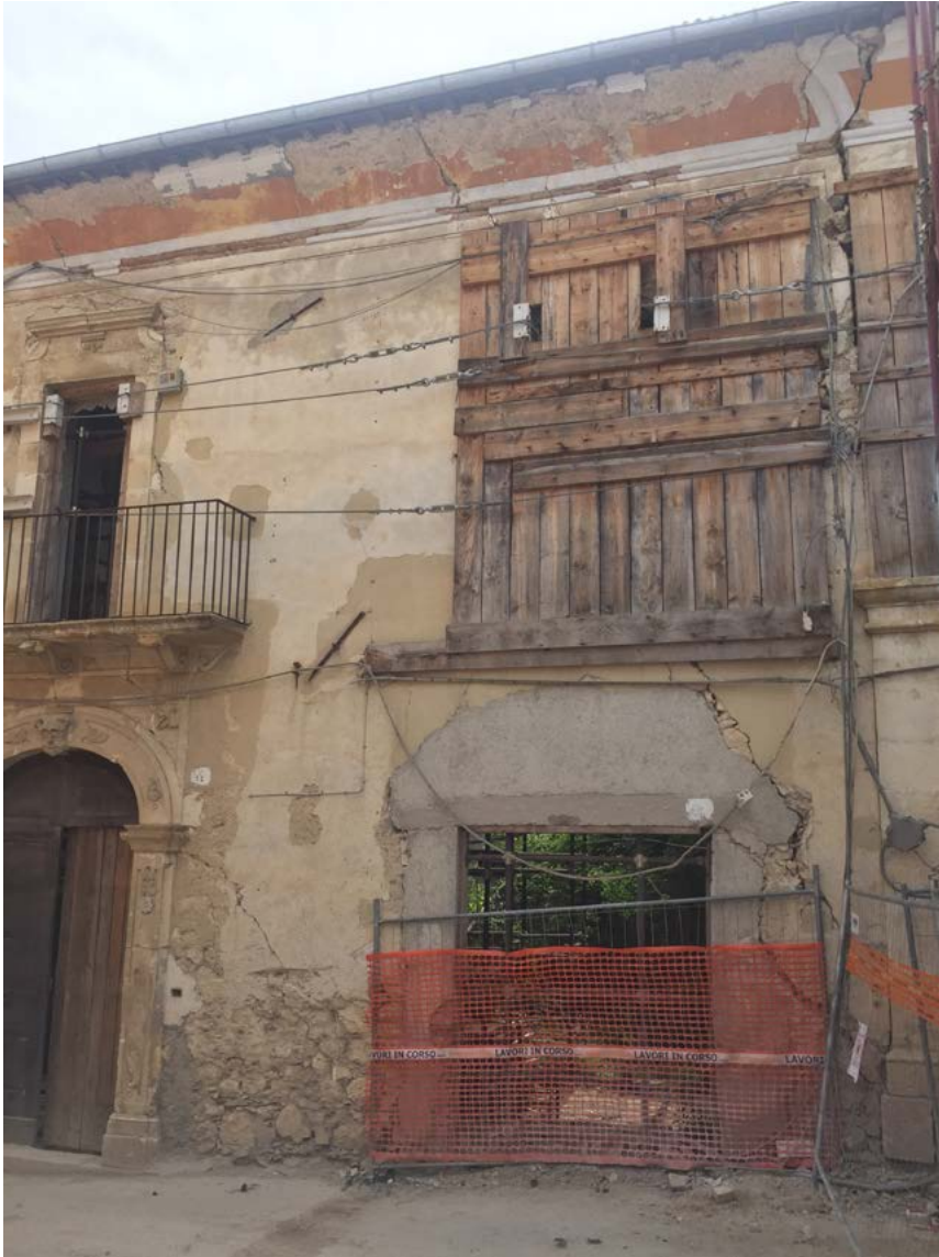
Figura 7. Villa Sant'Angelo (AQ), palazzo De Matteis in via Madonna delle Prata, giugno 2020. L'apertura di un garage sul fronte dell'edificio, in prossimità dell'angolo, ha ridotto la sezione resistente della muratura e concentrato i carichi sulle porzioni residue gravemente lesionate dalle sollecitazioni sismiche (foto C. Bartolomucci, 2020).
