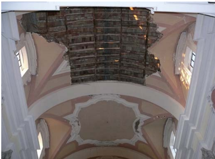
Figura 6. L'Aquila, chiesa di san Domenico (interno), ottobre 2009. Attraverso la caduta parziale della volta è possibile vedere la tecnica costruttiva (controsoffitto in telaio ligneo e incannucciata, rivestito all'intradosso da intonaco e stucchi) e, sullo sfondo, il tetto in laterocemento di recente sostituzione (foto C. Bartolomucci, 2009).
