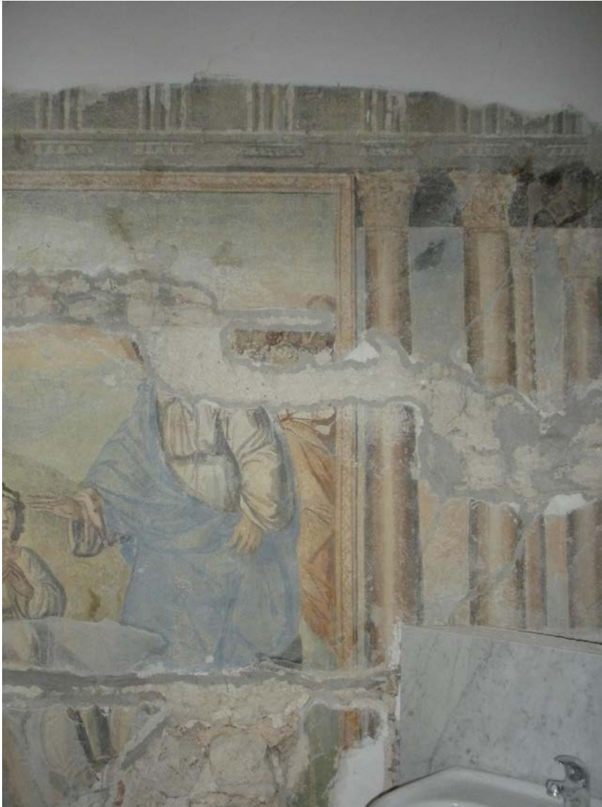
Figura 8. L'Aquila, palazzo Branconio, ottobre 2009. L'edificio, che presentava ambienti dipinti di notevole interesse (XVI secolo), è stato oggetto di rimozioni generalizzate dopo il sisma del 2009: gli affreschi sono stati staccati ovunque, ancor prima della documentazione del danno. Nella foto, un residuo dei dipinti in un ambiente di servizio (foto C. Bartolomucci, 2009).
