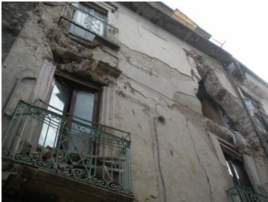
Figura 3. L'Aquila, porzione di fronte edificato su via Bominaco, agosto 2009. Si osservano i collassi delle porzioni murarie tra le finestre e la sopraelevazione di un piano; le lesioni verticali tra le due finestre del livello intermedio sembrano indicare un'apertura preesistente (foto C. Bartolomucci, 2009).
