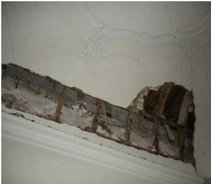
Figura 5. L'Aquila, monastero di San Basilio, gennaio 2010. Il danno sulla volta di controsoffitto ha reso visibile la struttura lignea della volta settecentesca, ornata da stucchi all'intradosso (gennaio 2010). In alcuni casi sono riemersi, al di sopra dei controsoffitti, finiture e intonaci dipinti che documentano configurazioni precedenti (foto C. Bartolomucci, 2010).
