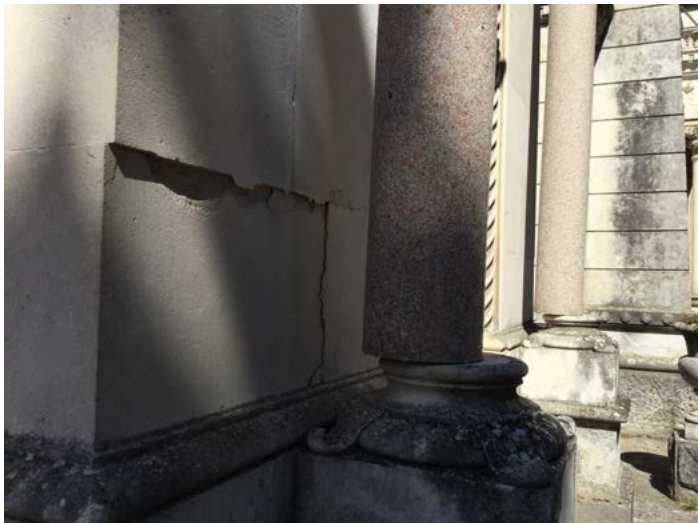
Figura 14. L'Aquila, Cimitero Monumentale, maggio 2020. Particolare del dissesto di una cappella gentilizia. Le colonne si presentano ancora oggi in una pericolosa situazione di instabilità; l'area è transennata ma non è stato adottato alcun provvedimento per evitare ulteriori danni da sovraccarico (foto C. Bartolomucci, 2020).
