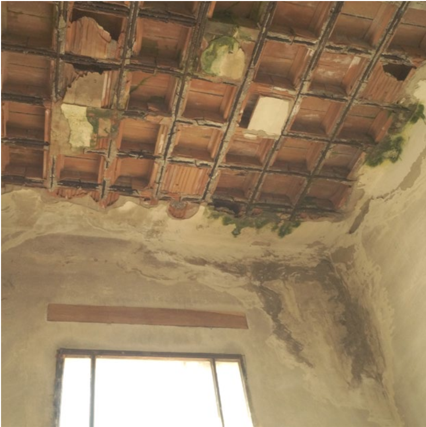
Figura 6. Predappio (Forlì-Cesena). Casa del Fascio. Dettaglio dello stato di conservazione del solaio di uno degli ambienti del primo piano (foto B. Verasani, V. Manzini, 2020).
