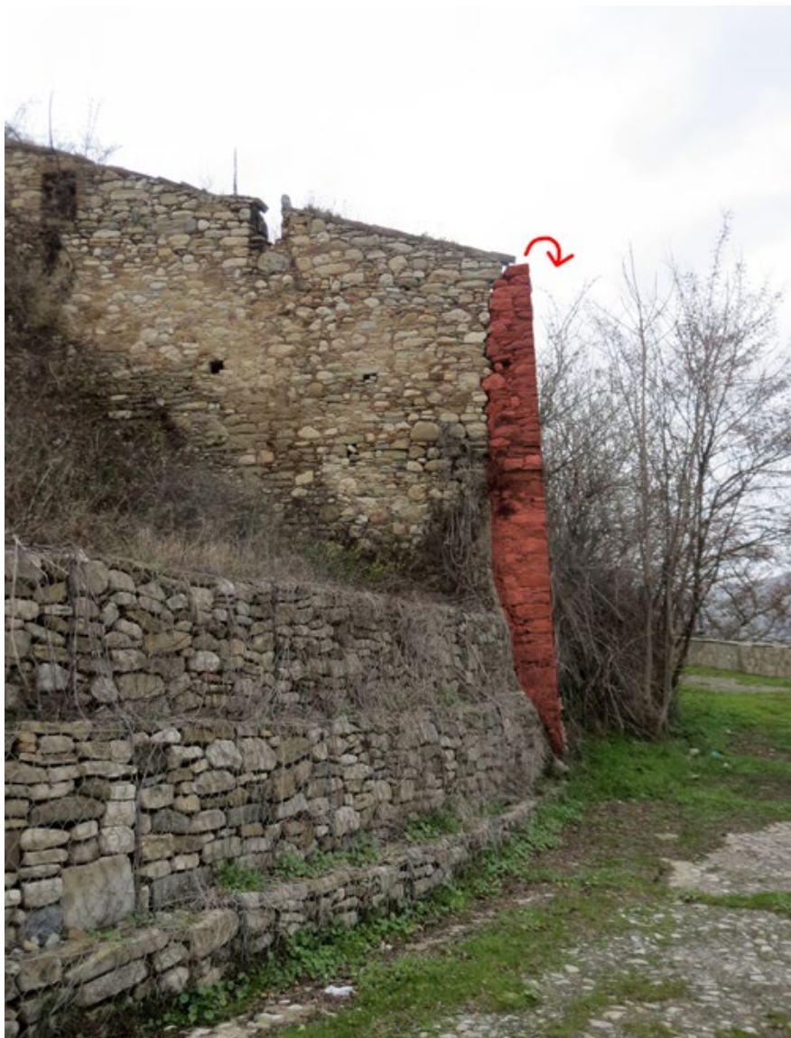
Figura 13. Rione Fossi, Accadia: visibile lesione di distacco della facciata dal muro di spina perpendicolare causata dalla spinta sismica orizzontale (foto ed elaborazione di G. Ajò 2018).
