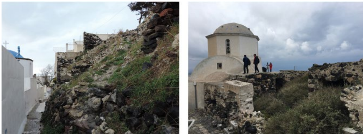
Figura 6. Edifici in stato di rudere prospicienti il percorso anulare inferiore (a sinistra) e nella parte alta del castello (a destra). In entrambi i casi l'accesso alle persone non è interdetto (foto C.F. Carocci, 2018).
