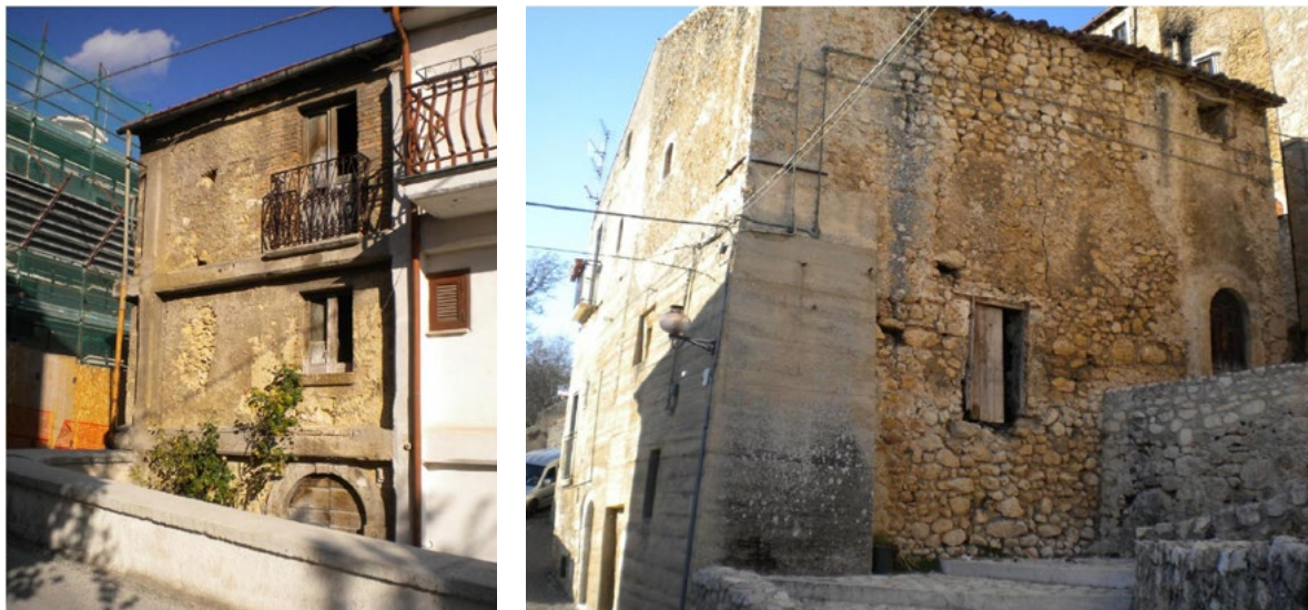
Figura 14. Esempi di presidi moderni in cemento armato introdotti dopo il sisma del 1915 in diversi centri minori dell’Abruzzo. L’immagine a sinistra ritrae un telaio appoggiato a una parete fronte strade di un edificio di Aielli Alto (L’Aquila), nel cuore della Marsica. Nell’immagine a destra si nota una fodera addossata a una parte dell’angolata di un’abitazione di Santo Stefano di Sessanio (L’Aquila), disposto alle pendici del Gran Sasso. In entrambi i casi i rinforzi risultano da un lato poco efficaci dal punto di vista strutturale, dall’altro profondamente alteranti l’immagine degli abitati (foto A. Donatelli, 2018).
