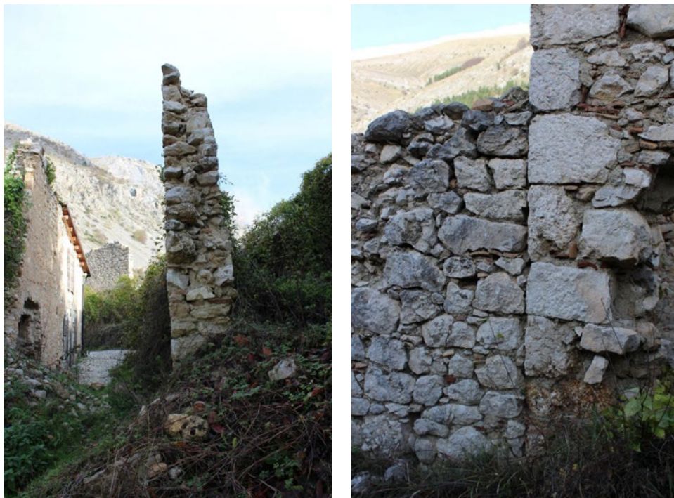
Figura 9. Frattura Vecchia, frazione di Scanno (L'Aquila). L'incipiente ribaltamento fuori dal piano di elevati (a sinistra) rappresenta il dissesto più diffuso verosimilmente dovuto al crollo degli orizzontamenti e all'assenza di efficaci collegamenti, ma anche favorito dalle discontinuità costruttive osservate fra pareti semplicemente accostate fra loro (a destra) (foto A. Donatelli, 2018).
