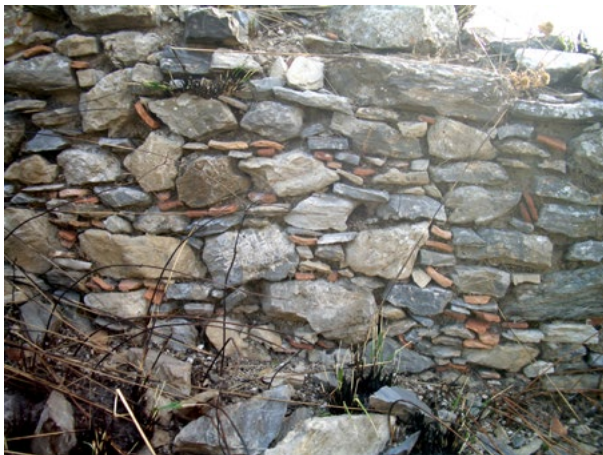
Figura 11. Particolare della muratura ricorrente nel sito, costituita in pietrame informe rinzeppato con cocci di laterizi (foto C. Genovese, 2016).
