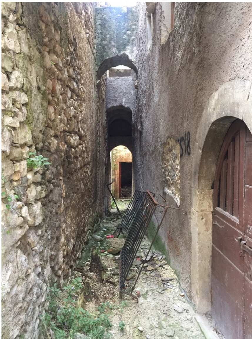
Figura 4. Carapelle Calvisio (L'Aquila). Tra le strade del centro storico (in abbandono dopo il sisma del 2009) si notano accorgimenti antisismici dei secoli scorsi, quali gli archi di contrafforte tra edifici diversi (foto C. Bartolomucci, 2018).
