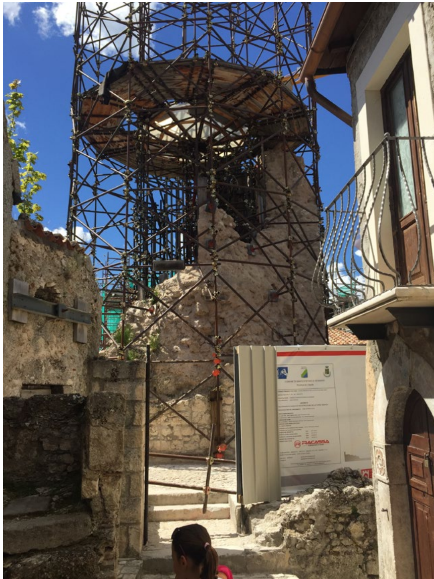
Figura 6. Santo Stefano di Sessanio (L'Aquila). I resti della torre medicea dopo il terremoto del 2009. Il valore simbolico è suggerito dai ponteggi che ne rievocano la forma, mentre la ricostruzione in corso sembra riproporla in forma identica, senza alcun segno del crollo avvenuto (foto C. Bartolomucci, 2018).
