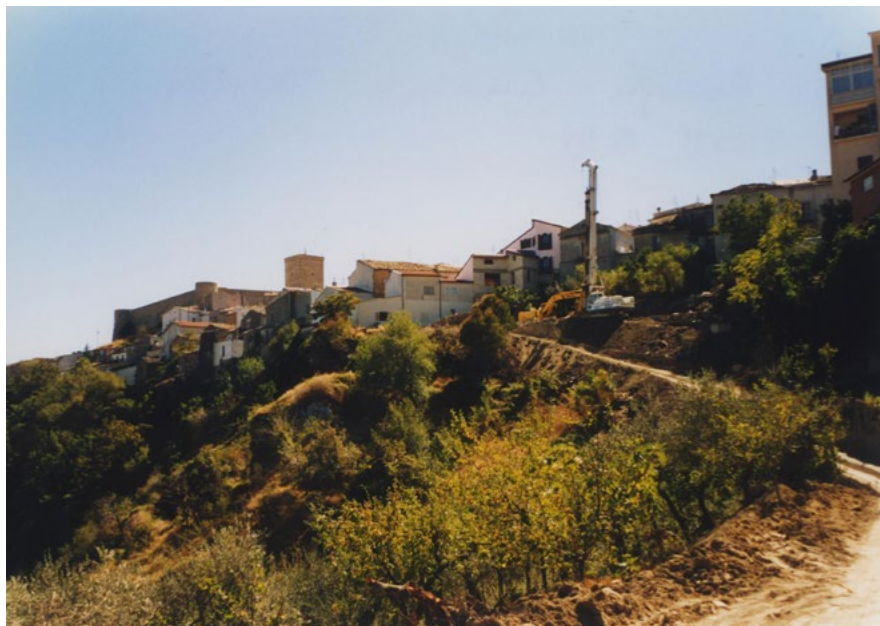
Figura 5. Fenomeni di dissesto idrogeologico nell'area di piazza Europa a Deliceto: il versante a ridosso del crinale abitato presentava diffusi segnali di cedimento (da database ReNDIS - web ISPRA - intervento ID 523-99, http://www.rendis.isprambiente.it/rendisweb/dettalioint.jsp?id=523/99 ) (ultimo accesso 28 marzo 2019).
