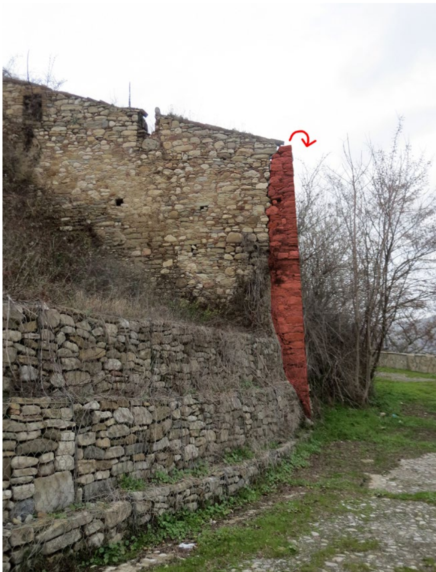
Figura 13. Rione Fossi, Accadia: visibile lesione di distacco della facciata dal muro di spina perpendicolare causata dalla spinta sismica orizzontale (foto ed elaborazione di G. Ajò 2018).
