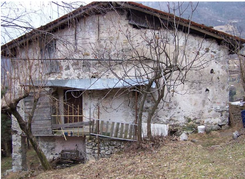
Figura 2. Marcheno, Brescia, cascina in località la Rocca. Nuove forme di riparazione improvvisate hanno introdotto materiali incongrui (foto B. Scala).
