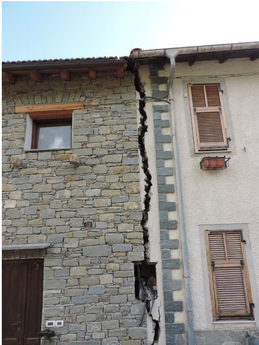
Figura 6. Mendatica (Imperia). Dissesti in edifici, recentemente ristrutturati, nella parte bassa del borgo (foto R. Vecchiattini, 2018).
