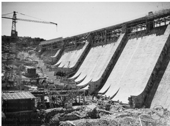
Figura 6. Il cantiere di costruzione della diga di Monte Pranu nei pressi della borgata di Palmas (Archivio dell'Istituto Luce).
