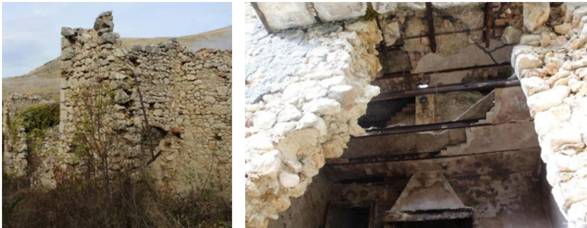
Figura 6. Frattura Vecchia, frazione di Scanno (L'Aquila). Dettagli costruttivi, come gli incatenamenti in ferro che corrono lungo lo spessore murario di diverse pareti e i solai in putrelle metalliche e voltine osservati in alcuni edifici disposti a valle della collina di insediamento del nucleo originario, denotano una seconda espansione dell'abitato databile fra la seconda metà del XIX secolo e i primi anni del XX (foto A. Donatelli, 2018).
