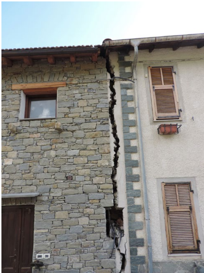
Figura 6. Mendatica (Imperia). Dissesti in edifici, recentemente ristrutturati, nella parte bassa del borgo (foto R. Vecchiattini, 2018).
