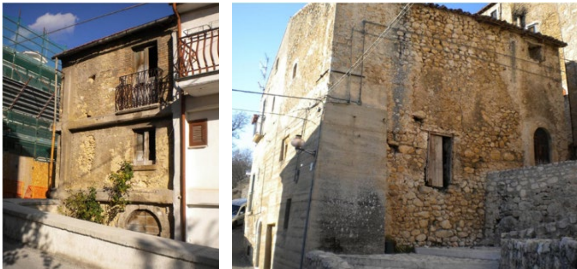
Figura 14. Esempi di presidi moderni in cemento armato introdotti dopo il sisma del 1915 in diversi centri minori dell’Abruzzo. L’immagine a sinistra ritrae un telaio appoggiato a una parete fronte strade di un edificio di Aielli Alto (L’Aquila), nel cuore della Marsica. Nell’immagine a destra si nota una fodera addossata a una parte dell’angolata di un’abitazione di Santo Stefano di Sessanio (L’Aquila), disposto alle pendici del Gran Sasso. In entrambi i casi i rinforzi risultano da un lato poco efficaci dal punto di vista strutturale, dall’altro profondamente alteranti l’immagine degli abitati (foto A. Donatelli, 2018).
