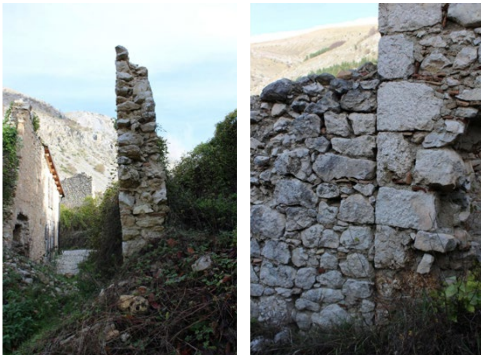
Figura 9. Frattura Vecchia, frazione di Scanno (L'Aquila). L'incipiente ribaltamento fuori dal piano di elevati (a sinistra) rappresenta il dissesto più diffuso verosimilmente dovuto al crollo degli orizzontamenti e all'assenza di efficaci collegamenti, ma anche favorito dalle discontinuità costruttive osservate fra pareti semplicemente accostate fra loro (a destra) (foto A. Donatelli, 2018).
