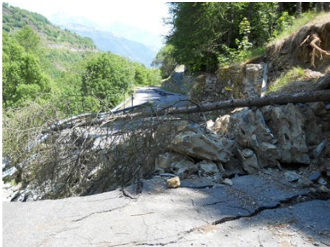
Figura 7. Triora (Imperia). Dissesti della sede stradale nella frazione di Monesi di Triora (foto R. Vecchiattini 2017).
