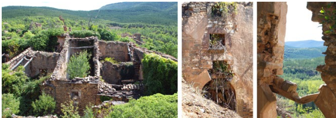
Figura 2. Stato attuale di Ruesta. Fattori biotici, abiotici e antropici responsabili del degrado (foto ©Sergio Sebastián Architects, 2017).
