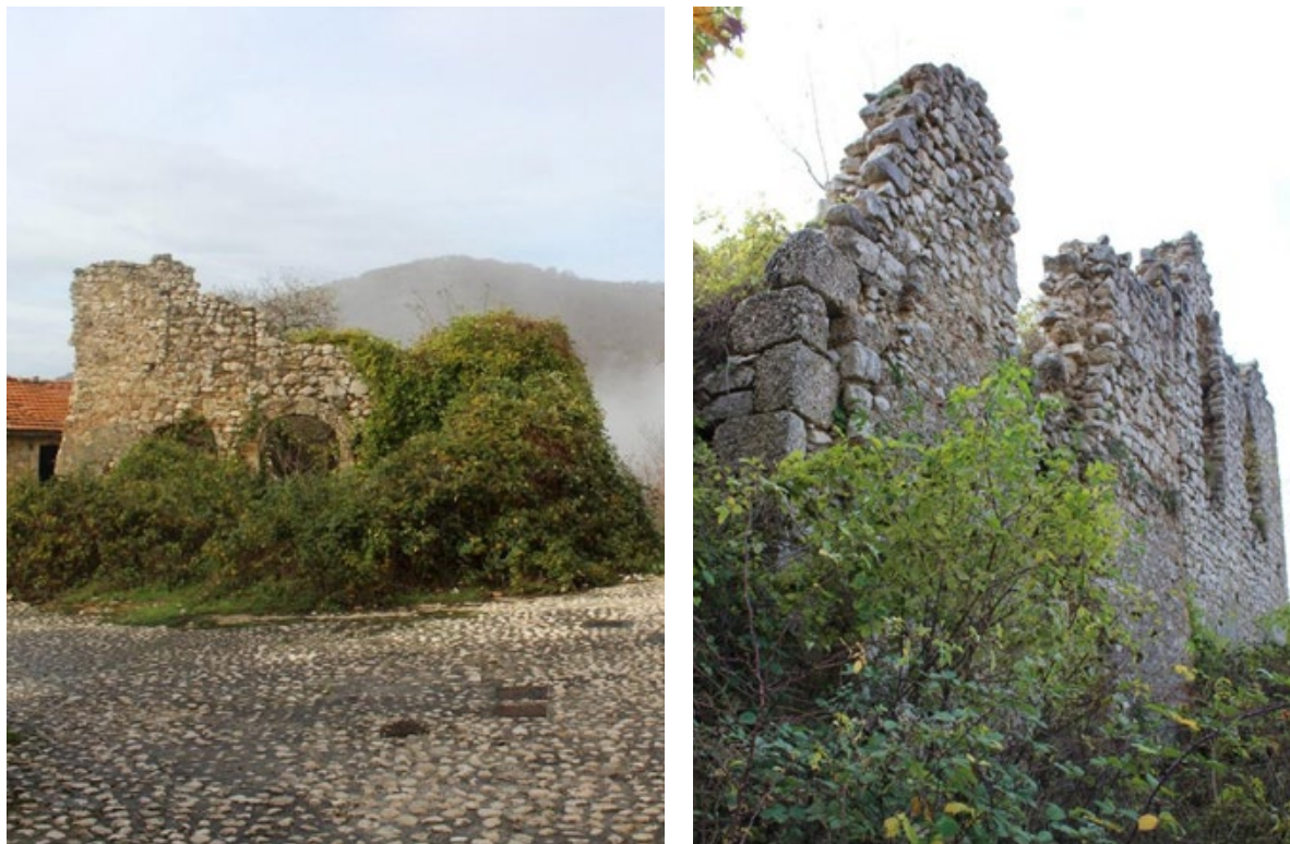
Figura 3. Frattura Vecchia, frazione di Scanno (L'Aquila). Esempi di presidi antisismici introdotti dopo il violento sisma del 1706: a sinistra un contrafforte e a destra un ringrosso murario (foto A. Donatelli, 2018).
