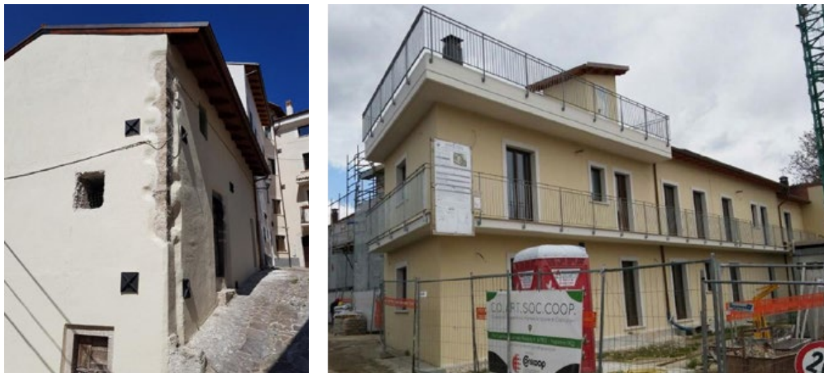
Figura 15. Esempi di interventi successivi al terremoto del 2009. L'immagine a sinistra ritrae un edificio di Rocca di Mezzo (L'Aquila) oggetto di riparazioni e rinforzi antisismici. In particolare si nota il rifacimento dell'intonaco esterno sostituito con un premiscelato fibro-rinforzato di notevole spessore, tale da sovrapporsi, erroneamente, agli stipiti delle aperture; sono inoltre parzialmente lasciate in vista le pietre dell'angolata con un esito nel complesso trasfigurante (foto A. Donatelli, 2019). Nell'immagine a destra si osserva un aggregato ricostruito in sagoma, con una struttura in cemento armato, nella frazione di Onna (L'Aquila), gravemente danneggiata dal recente sisma (foto A. Donatelli, 2017).
