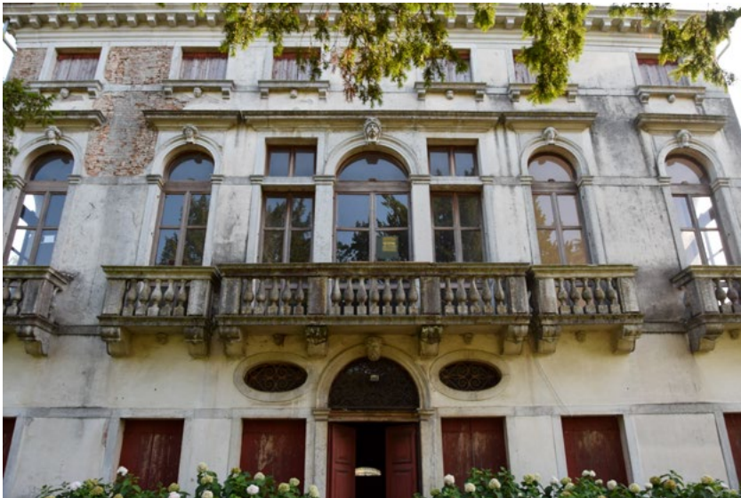
Figure 4-5. Canda (Rovigo). Villa Nani Mocenigo. In alto, veduta del fronte orientale (foto V. Balboni, 2015); a sinistra, veduta del fronte settentrionale (foto E. Montalti, 2019).
