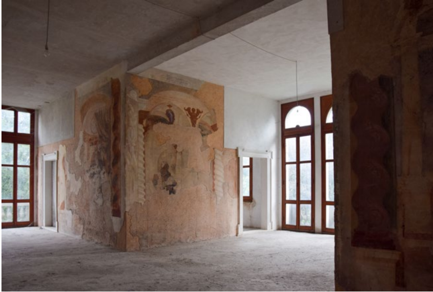
Figura 37. Canda (Rovigo). Villa Nani Mocenigo, veduta interna del primo piano, stato attuale (foto E. Montalti, 2018).
