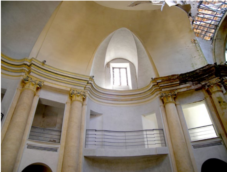
Figura 20. Camerino, oratorio, già chiesa, di San Giovanni Battista, particolare delle coppie di colonne con trabeazione inflessa (foto A. Roca De Amicis, 2018).
