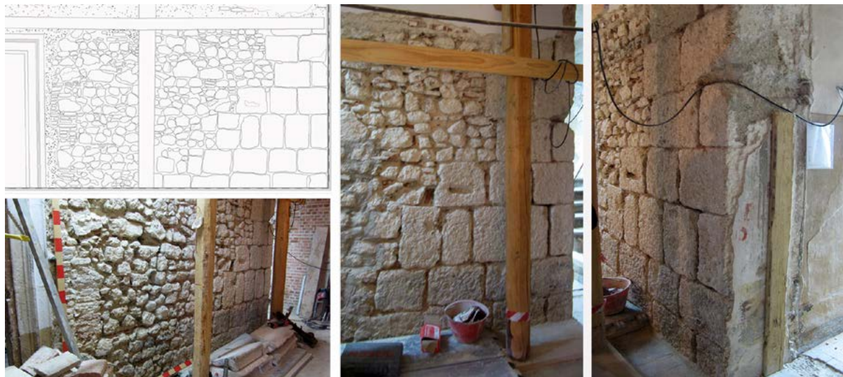
Figura 7 a-d. L'Aquila, palazzo Ardinghelli, muratura di una probabile cellula medievale originaria (foto e rilievi di S. Cecamore).
