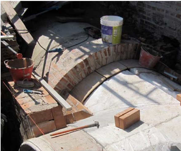
Figura 24 a-b. L'Aquila, palazzo Ardinghelli, ricostruzione dei pilastri e delle volte della loggia (foto di S. Cecamore).
