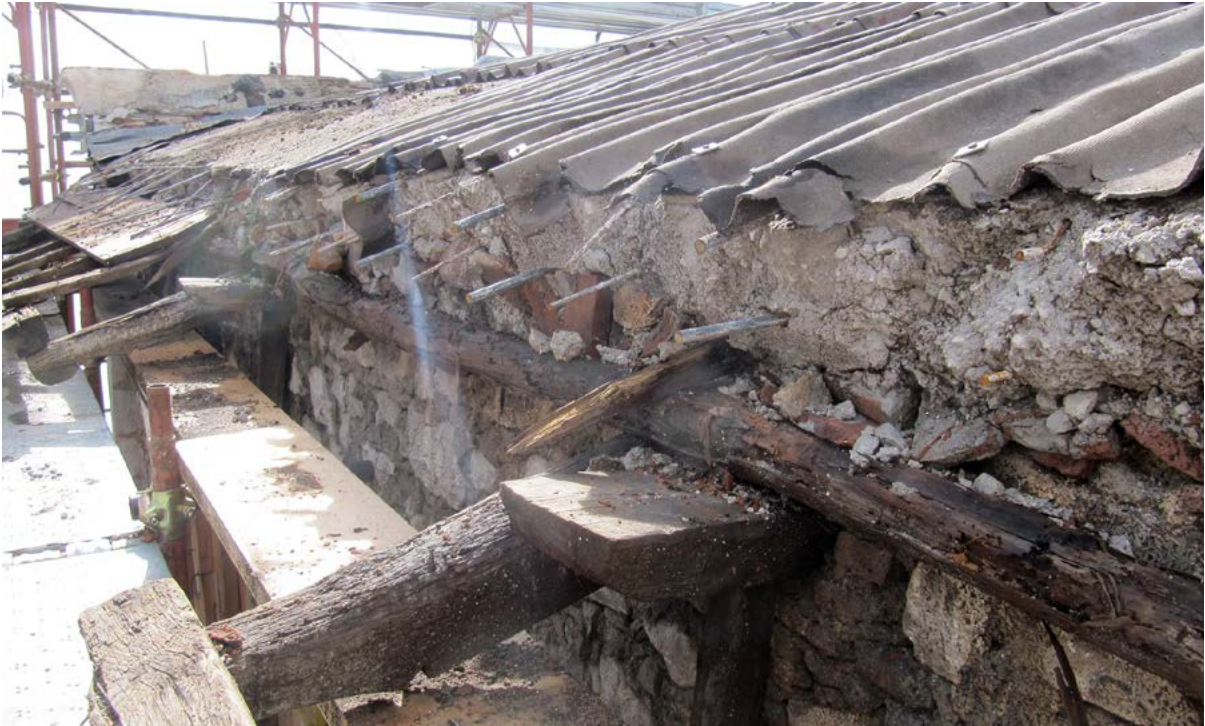
Figura 16. L'Aquila, chiesa dei Santi Marciano e Nicandro, demolizione della copertura in cemento armato (foto di S. Cecamore).
