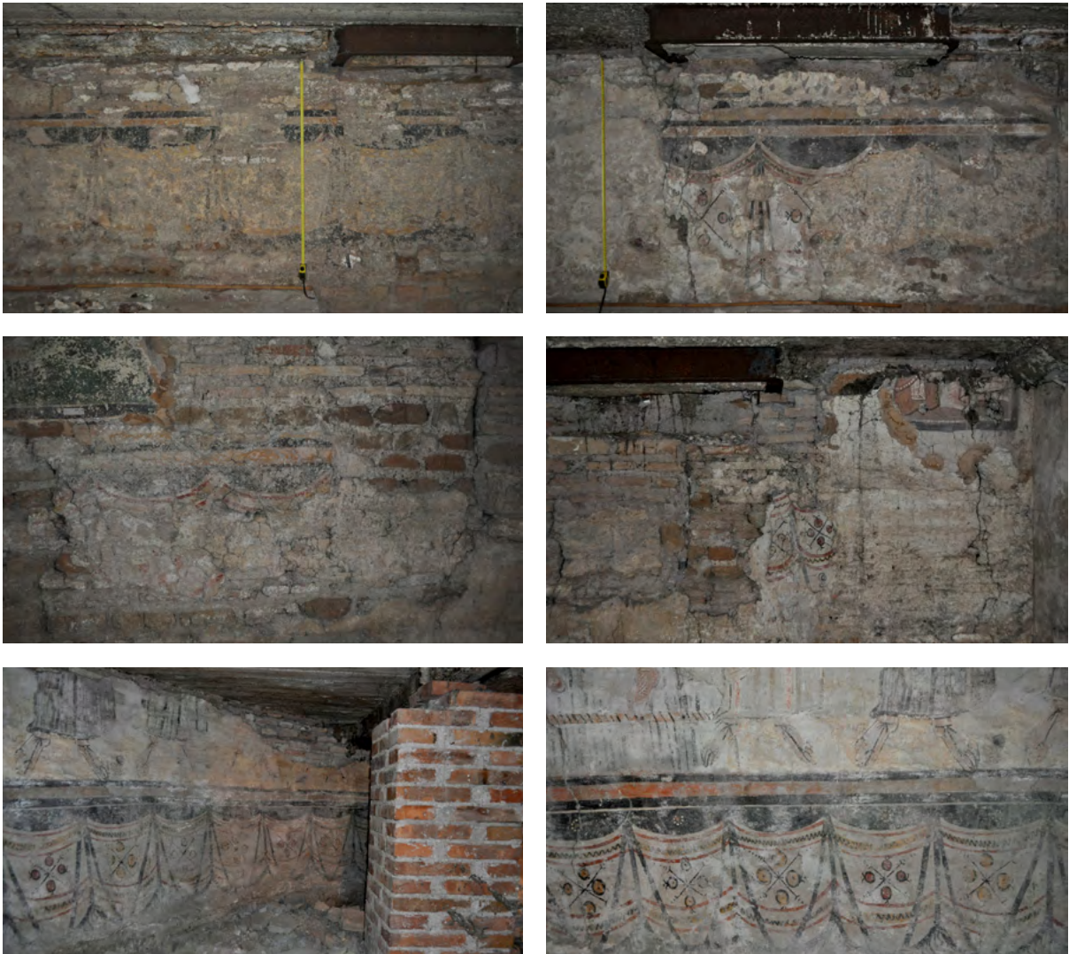
Figura 15. Velari delle pareti longitudinali e dell'abside. Dall'alto in senso orario: a) zona centrale della parete sud (I5); b) angolo est della parete sud (I3); c) zona centrale della parete nord (I3); d) angolo est della parete nord (I3 e, sotto, I14); e) e f) abside (I3) (foto S. Cutarelli).
