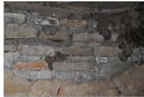
11E.17_03 - dettaglio dopo il prelievo
