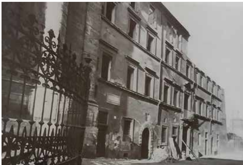
Figura 34. L'Ospedale dei Fiorentini (dell'Arciconfraternita della Pietà) in demolizione, fotografia (da SALERNO, SPEZZAFERRO, TAFURI 1973, p. 257).
