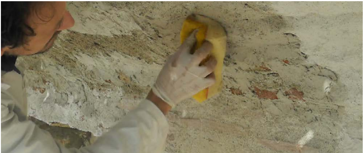
Figure 28-29. Savona, santuario di Nostra Signora della Misericordia, fronte principale dell'Ospizio dei poveri. Applicazione a spatola della malta di calce e successivo “ripassamento” a spugna bagnata (foto S.F. Musso, 2013).
