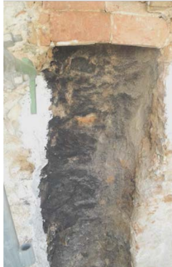
Figura 41. Savona, santuario di Nostra Signora della Misericordia. Dettagli della canna fumaria "in spessore di muratura" scoperta in fase di cantiere (foto S.F. Musso, 2013).
