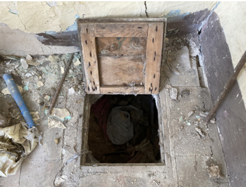
Figura 26. Botola di accesso al vano tra volta e controvolta sul pavimento del livello superiore in una casa di Granfonte (foto di C.F. Carocci, 2023).
