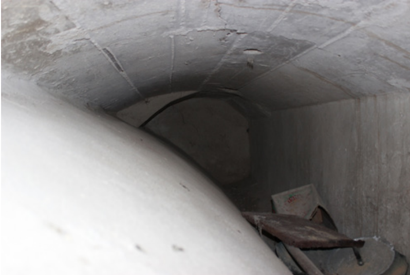
Figura 25. Vano tra l'intradosso della volta di interpiano e la controvolta in una casa di Granfonte (foto di C.F. Carocci, 2023).
