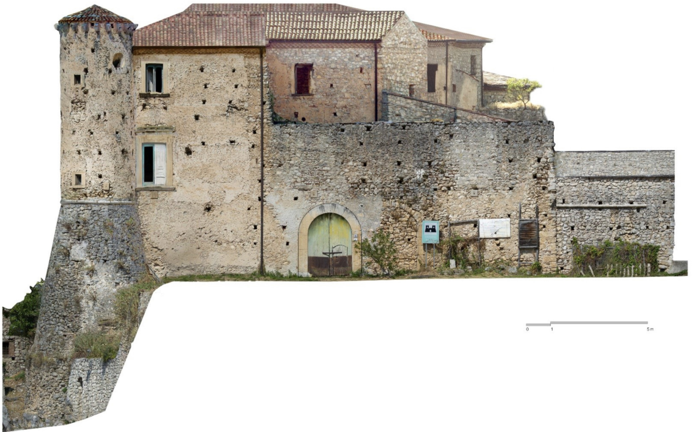
Fig. 5 - Castello di Sant'Angelo a Fasanella, ortofoto del prospetto est. (fonte: elaborazione di F. P. Iannece, Università degli Studi di Salerno, Dipartimento di Ingegneria Civile, tesi di laurea in Restauro Architettonico, relatore prof.ssa Emanuela De Feo, a.a. 2022-2023)
